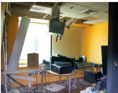
Figura 2. Edificio nuevo de hormigón sin daños estructurales situado en Santiago (fotografía superior izquierda). Se pueden observar las ventanas intactas y los daños por agua debidos a la rotura de las tuberías en plantas superiores (fotografía superior derecha). Las dos fotografías inferiores muestran los daños interiores en mamparas de oficinas inadecuadamente fijadas, lámparas suspendidas y otras instalaciones, tejados suspendidos, calefacción suspendida, aparatos de aire acondicionado y ventilación, ordenadores (fotografía derecha), etc.
