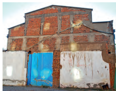
Figura 8. Edificio de albañilería confinada ligeramente dañado en Talca, una de las ciudades más afectadas por el terremoto de Chile en 2010.
